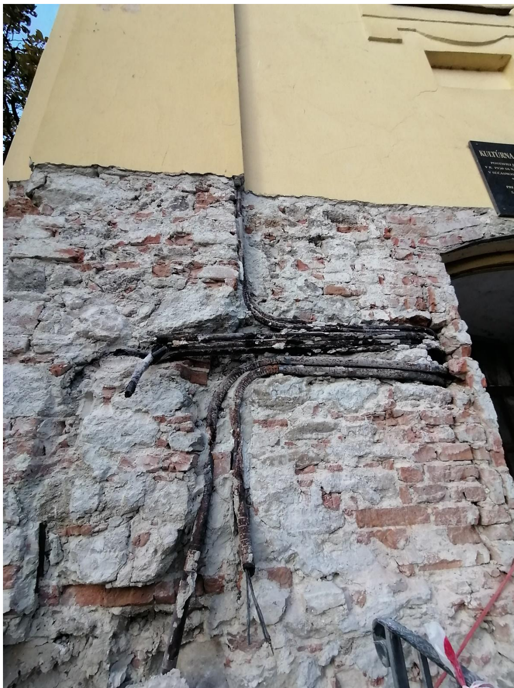
Stará nefunkčná skorodovaná elektroinštalácia
